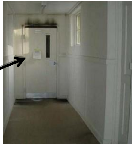
Compartment 2 – beperkte rookdoorslag
